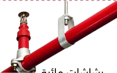
رشاشات مائية Water Sprinklers
